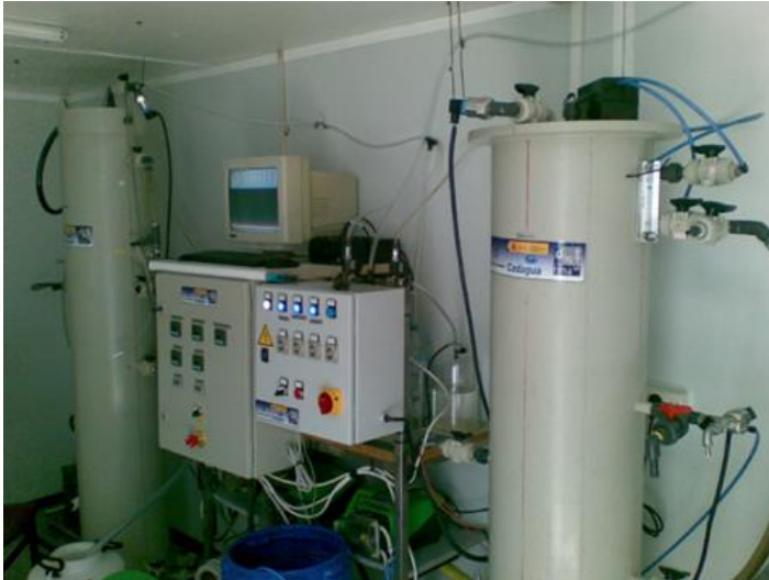
Tratamiento de aguas residuales
